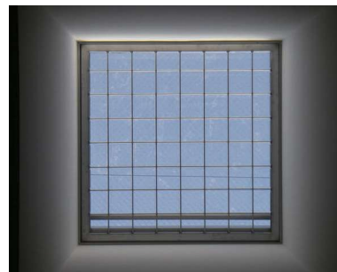
AS見上げ 結露受け部に落下防止ネット付き
