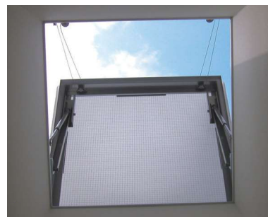
片側開閉 見上げ（開閉途中）
